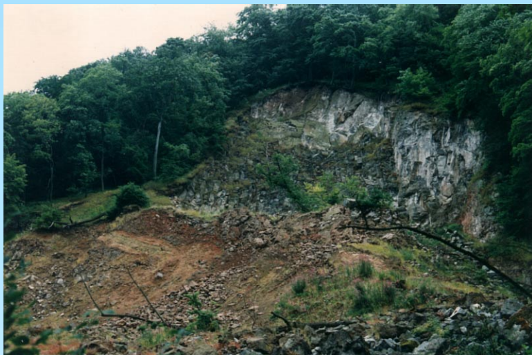
Sesuv na Čertovce u Ústí nad Labem v roce 1995 ohrozil lidská sídla. Zabezpečení vyžadovalo podrobný průzkum a složité technické zákroky.
