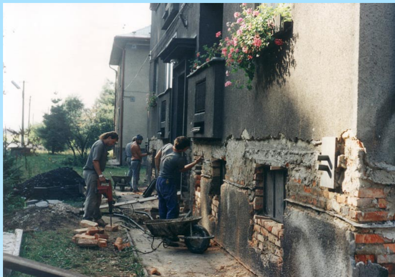
Katastrofální vliv antropogenních poklesů zemského povrchu na stavby. Rychlý pokles je způsoben poddolováním. Stavba je sanována technologií hydraulické nivelace. Foto F.Reichmann.
